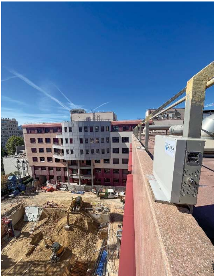
Suivi de l'impact de travaux d'extension d'un hôpital à Marseille. Monitoring extérieur en complément du monitoring particulière de ses blocs opératoires.
